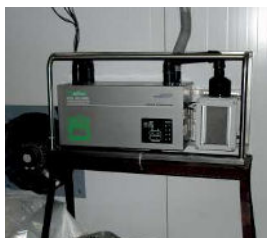
illustration du procédé Vectoclean, installé dans un local de stockage à bouchon.
